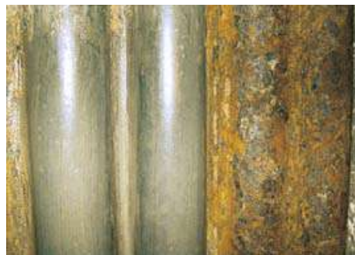
▲ ごみ焼却炉（処理能力:450トン）で3年後の皮膜の状態写真。表面は滑らかでかつ、金属光沢を維持している。
