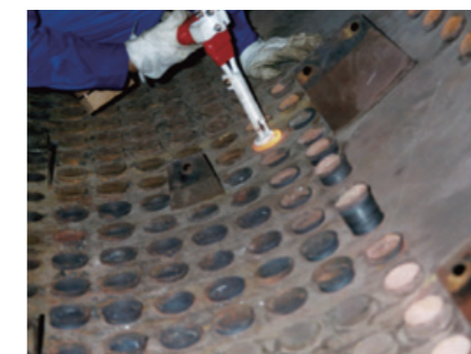
ボイラーチューブ弛緩工事 ボイラーチューブ拡張部を加熱し管を緩め抜き取る工法であり、管板を傷つけることなく、簡単に抜き取り可能。
