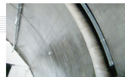
⑤ 高速道路(トンネル消防火配管) 樹脂ライニング技術
