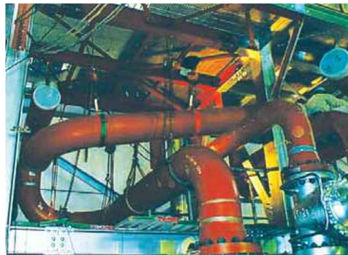
ゴミ処理プラント(溶接安全管理審査対象管)
